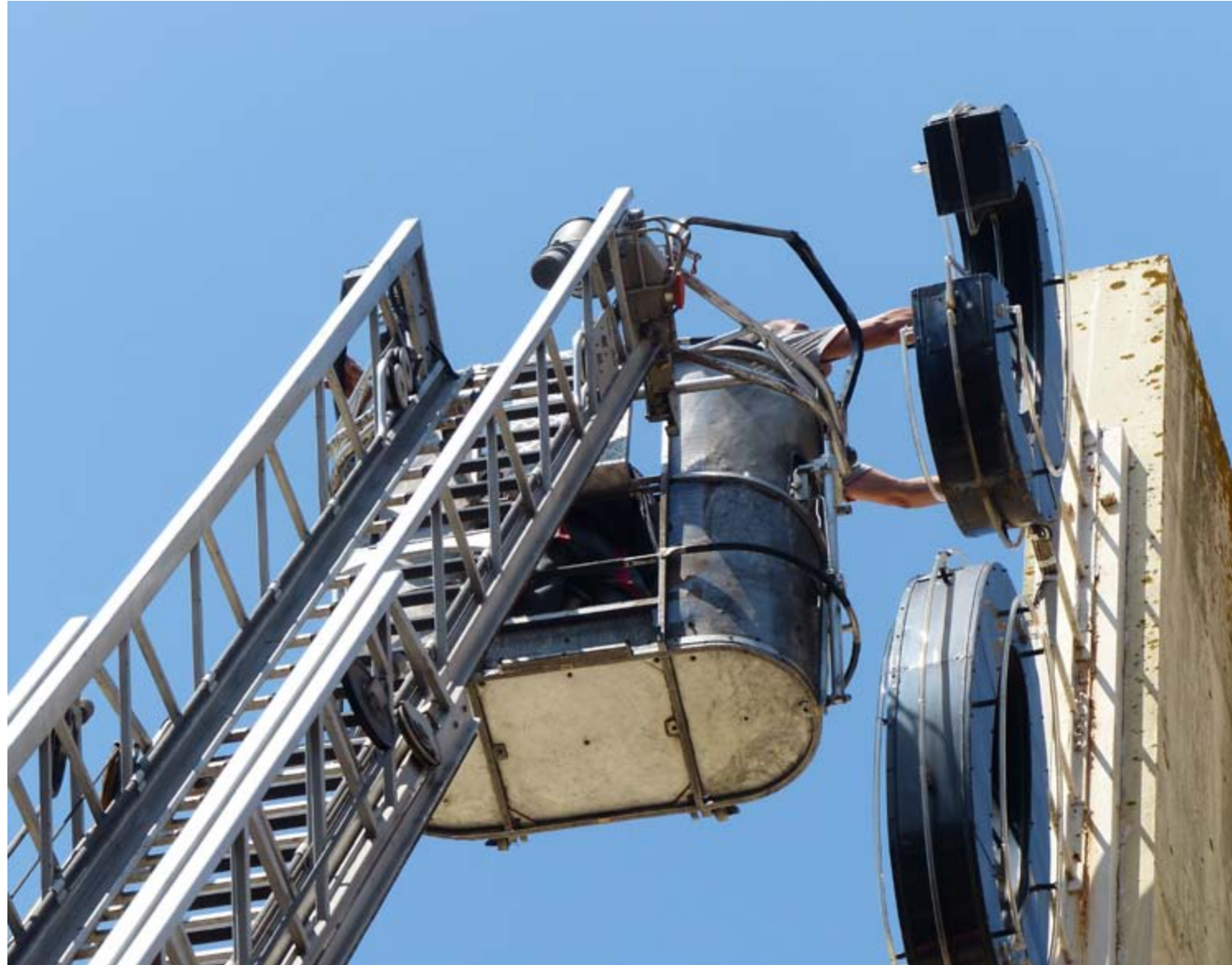
Eine Reparatur an den Neonbuchstaben des Coliseu in Porto, Portugal. Foto: ph.
